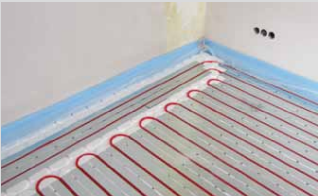
Fertig verlegtes Heizsystem TS
