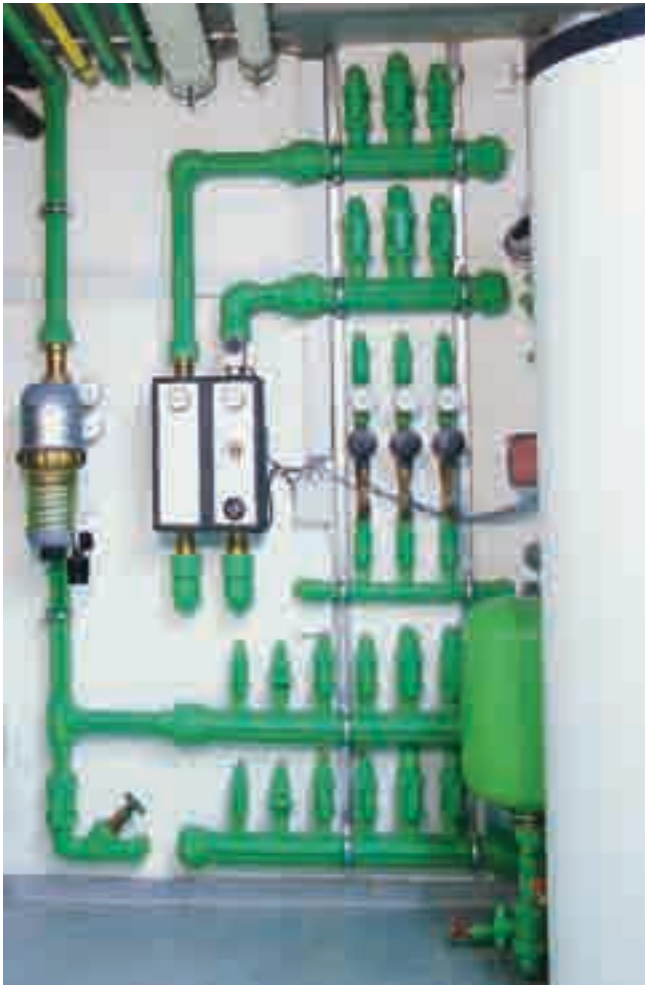
Verteilerbau Sanitär und Heizung (Wohngebäude)
