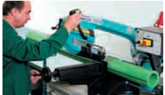
Vor dem Schweißvorgang erfolgt das Ablängen des Rohres auf die gewünschte Rohrlänge
