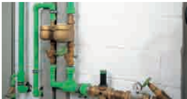
Von der Hausanschlussstation, der Kaltwasserverteilung, dem Boileranschluss und dem Warmwasserverteiler...
