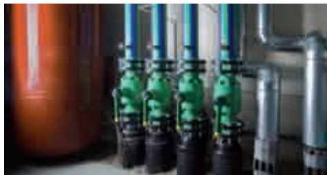
Flanschverbindungen und Übergangverschraubungen ermöglichen den Anschluss aller Elemente in der Versorgungszentrale und weiterhin auf der Etage.
